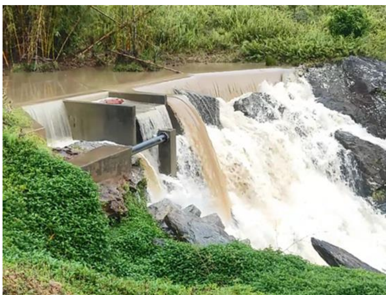
Figure 5 – Photographie au niveau de la prise d'eau du captage d'Haccinem à la fin de la crue du 17/10/2018
