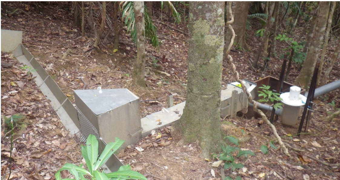
Figure 20 – Vue isométrique 3D de la conception Autocad du dispositif installé à l'exutoire des parcelles (a - Source : RESCCUE - Q. Delvienne et E. Ebrard) et photographie de ce dispositif à l'exutoire de la parcelle SCAR (b - Jean-Jérôme Cassan – PN, le 21/06/2018).
