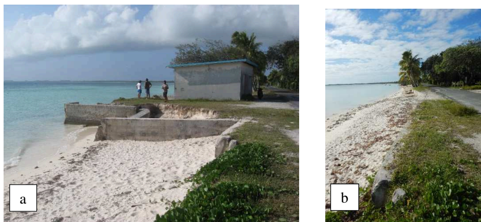
Figure 157 : Aménagement bloquant le transit sédimentaire longitudinal, retiré au cours du premier trimestre 2016. a/ Octobre 2015, b/ Avril 2016. (Photographies : Matthieu Le Duff).
