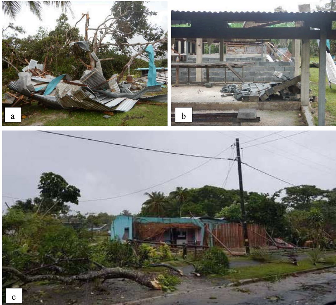
Figure 58 : Photographies prises à la suite du passage de la trombe marine à Qanono (Lifou), le 11 avril 2017. (photographies : a,b : Dégâts à la maison commune de Qanono, Matthieu Le Duff ; c : Dégâts au petit marché de la chefferie de Qanono, ©Shedysong Caihé).
